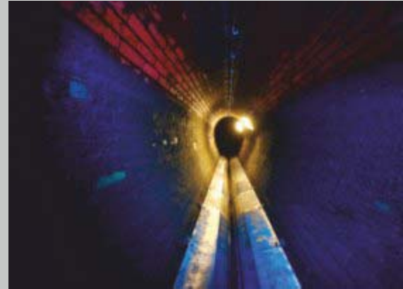
Abwasserwärmeübertrager (Quelle: ECO.S)
