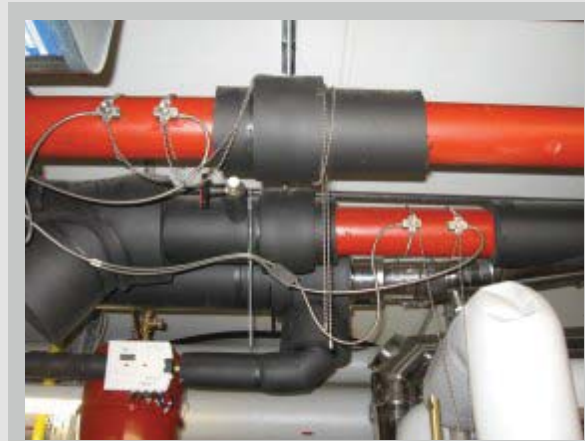
Clamp-On-Durchflussmessung im Wärmetauschersystem
