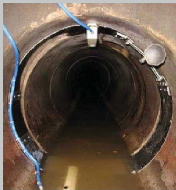
Durchflussmessstelle: Sensoren für Fließgeschwindigkeits- und Füllstandsmessung
