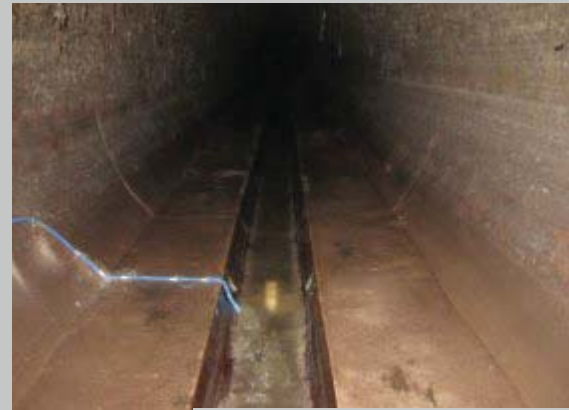
Durchflussmessstelle: Sonderprofil mit Trockenwetterrinne
