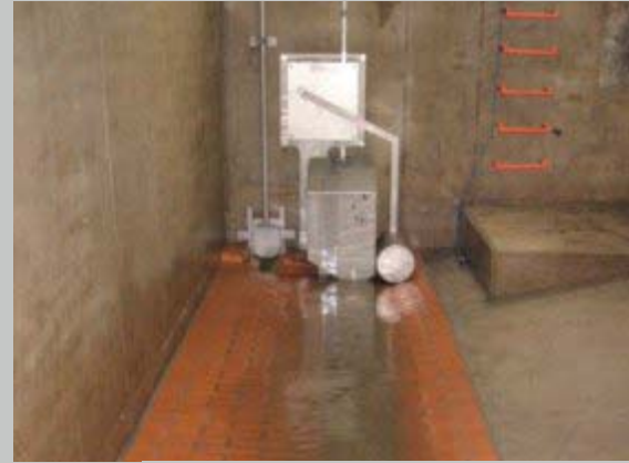
RÜB – Fangbecken im Hauptschluss mit mechanisch gesteuerter Drosselblende
