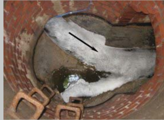
Maßgebliche Durchflussmessstelle für Einleitungen (DN 300, sohlgebundene Geschwindigkeitssonde)
