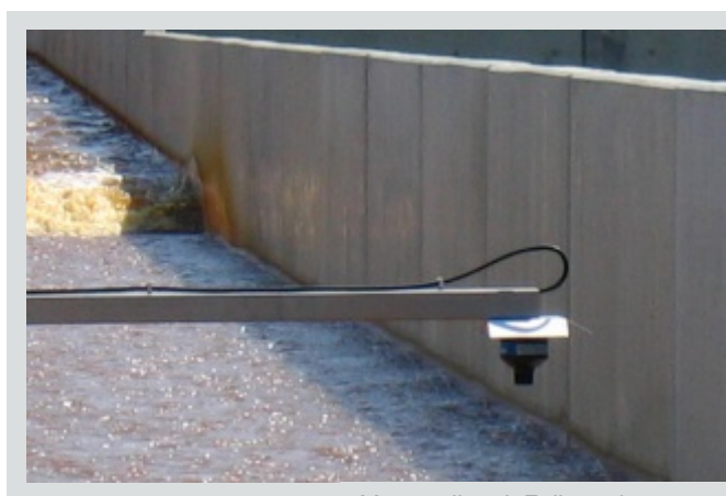
Messstelle mit Füllstandssensor
