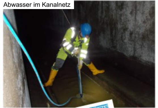
Abwasser im Kanalnetz
