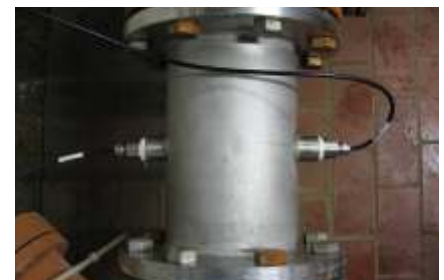
Inline-Montage der Sensoren
