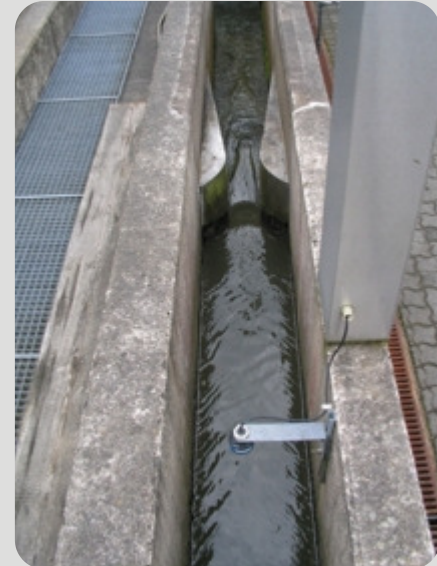
Venturimessung im Ablauf
