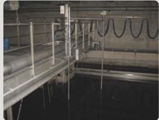
Rechteckbecken mit Räumbrücke
