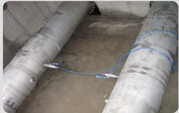
Messschacht nach dem Sandfang
