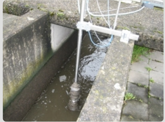
NH 4 -N Messung im stark verschmutzten Kläranlagenzulauf
