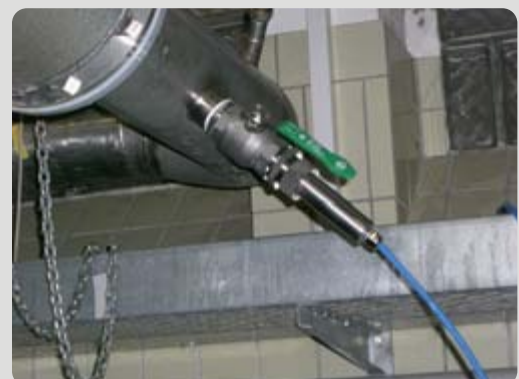
Messstelle mit eingebautem Sensor
