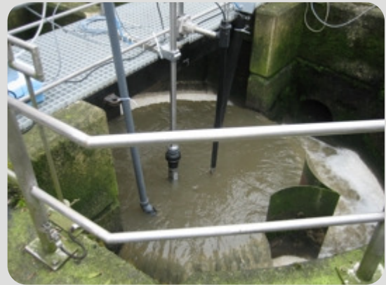
NH 4 -N Messung im Verteilerbauwerk zur Biologie
