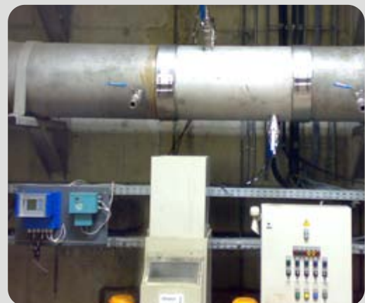
Eingebaute Sensoren in der Leitung
