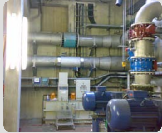
Pumpenkeller mit Ablaufleitung an der Rückwand
