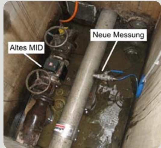
Ansicht Messstelle von oben
