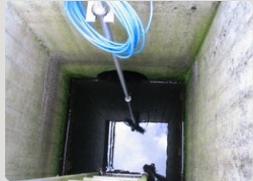
Trübungsmessung am Kläranlagenauslauf
