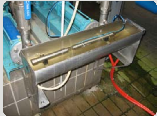
Spektrometersonde zur TOC-Messung im Bypass
